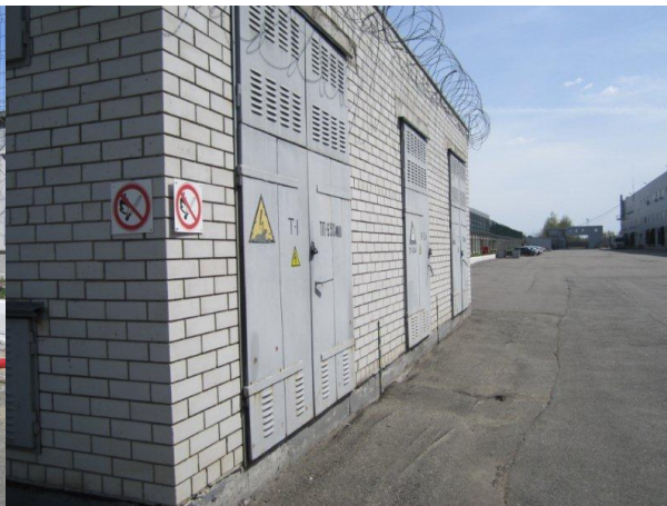
Фото №4. Трансформаторна підстанція
