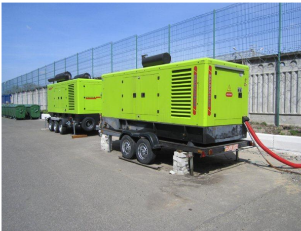
Фото №3. Дизель-генератори резервної напруги
